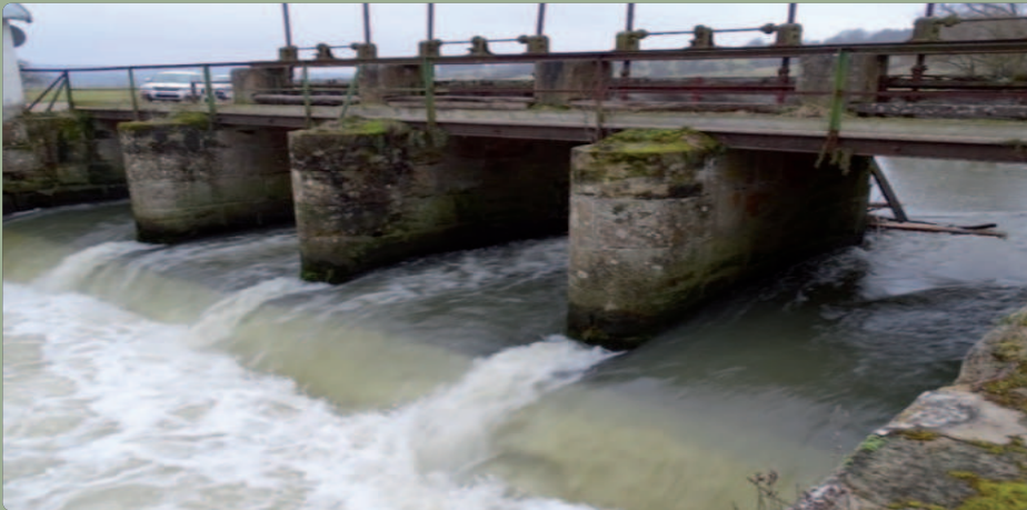
Abbildung oben: doppelter Sohlabsturz durch das Wehr
